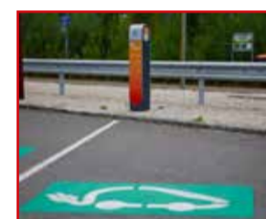
Elektrozapfsäule, Bahnhof / Borne électrique, gare Lorentzweiler
